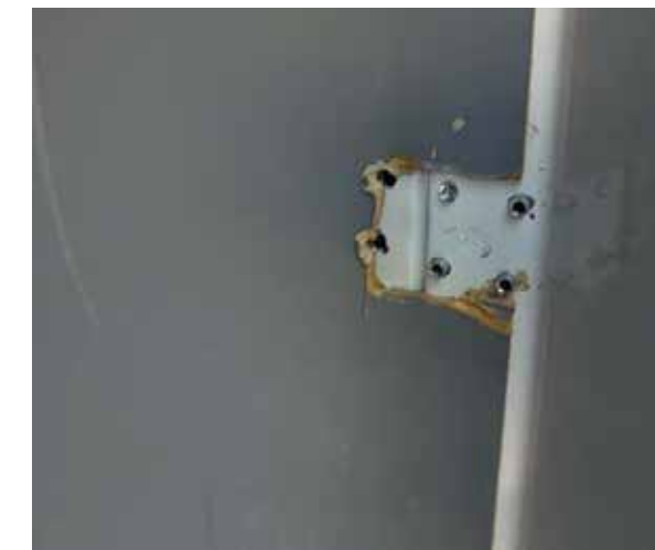
Tragovi nestručne izgradnje opreme
