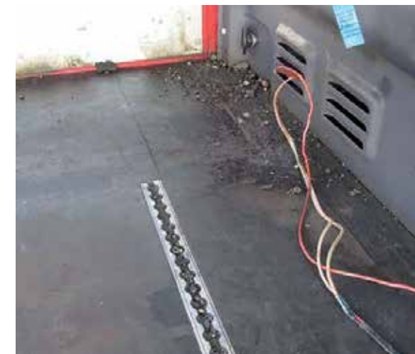
Neispravna instalacija kabela
