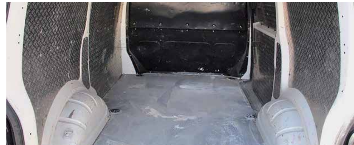
Neprihvatljivo stanje teretnog prostora
