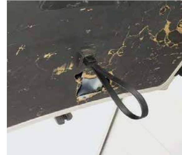
Veće oštećenje stražnje obloge
