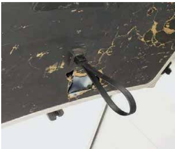
Veće oštećenje stražnje obloge
