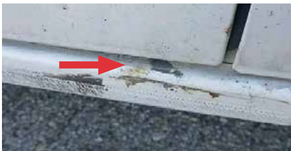
Oštećena boja na okviru vrata
