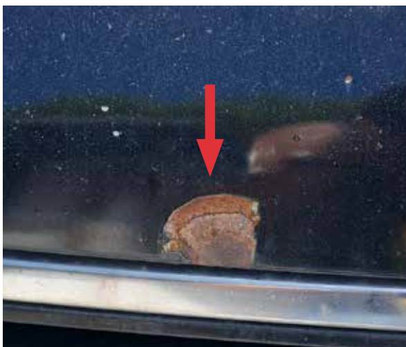
Veći udari kamena s korozijom
