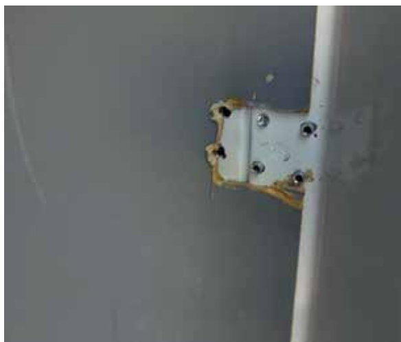
Tragovi nestručne izgradnje opreme
