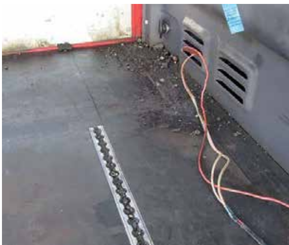
Neispravna instalacija kabela
